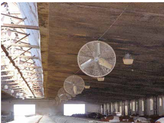
Veľkoplošné ventilátory podporujúce prúdenie vzduchu v maštali.
